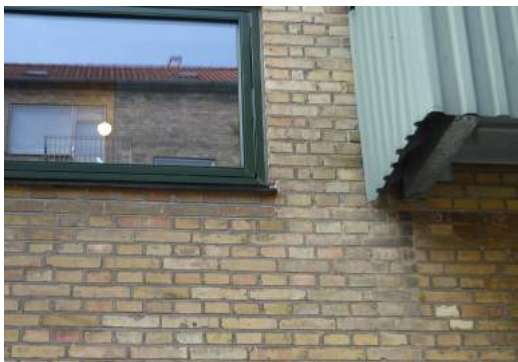
Foto 1: Træ/alu vindue med udvendig gummifuge
