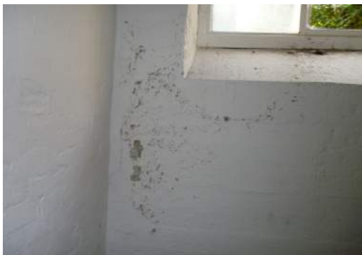
Foto 1: Afskallet puds og "bobler" i maling/puds
