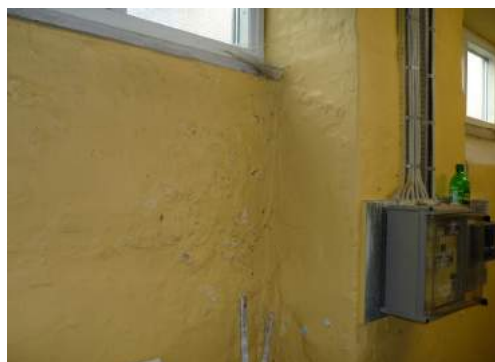
Foto 2: Afskallet puds og "bobler" i maling/puds
