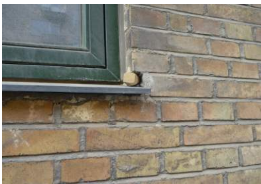
Foto 1: Tilskåret mursten er løs ved sålbænk
