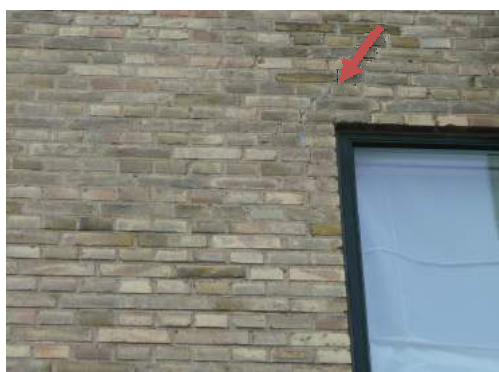
Foto 2: Sætning ved vindue
